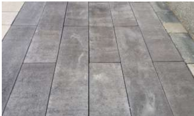
vápenný výkvet na dlažbe
