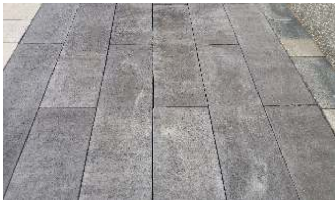
vápenný výkvet na dlažbe
