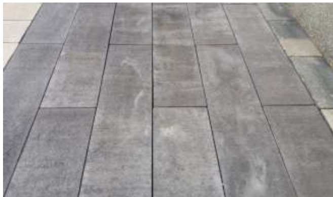
vápenný výkvet na dlažbe
